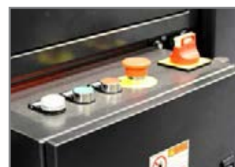
PANNELLO DI CONTROLLO CONTROL PANEL
