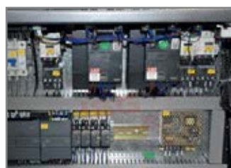
QUADRO ELETTRICO GESTITO DA PLC MACHINE CONTROLLED BY PLC
