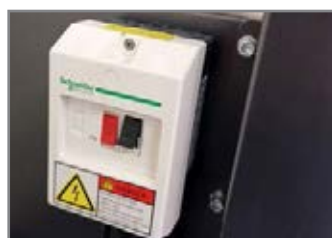
INTERRUTTORE GENERALE MAIN POWER SWITCH
