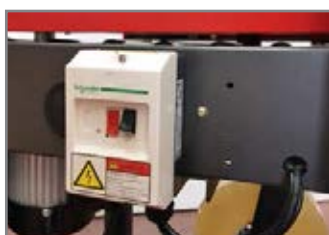
INTERRUTTORE GENERALE MAIN POWER SWITCH
