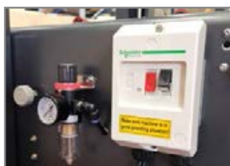
INTERRUTTORE GENERALE MAIN POWER SWITCH
