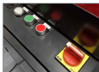
PANNELLO DI CONTROLLO CONTROL PANEL
